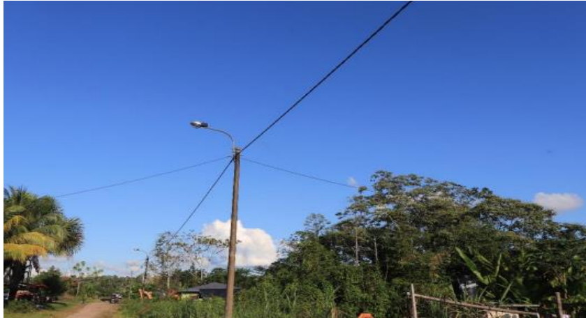
FIGURA 148: IMAGEN DE POSTES DE LUZ Y RED ELECTRICA
