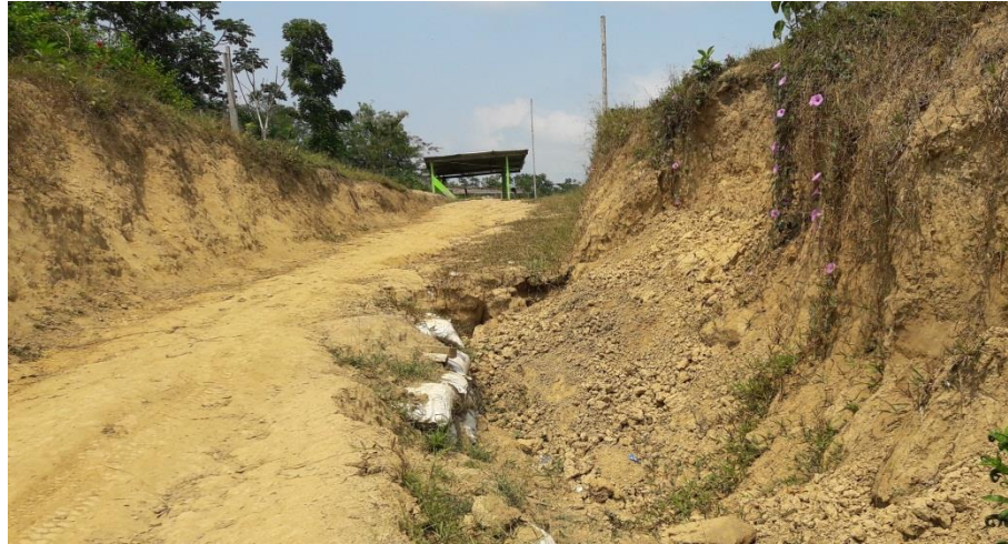
Figura N° 63: VIA EN PESIMO ESTADO DE CONSERVACION
