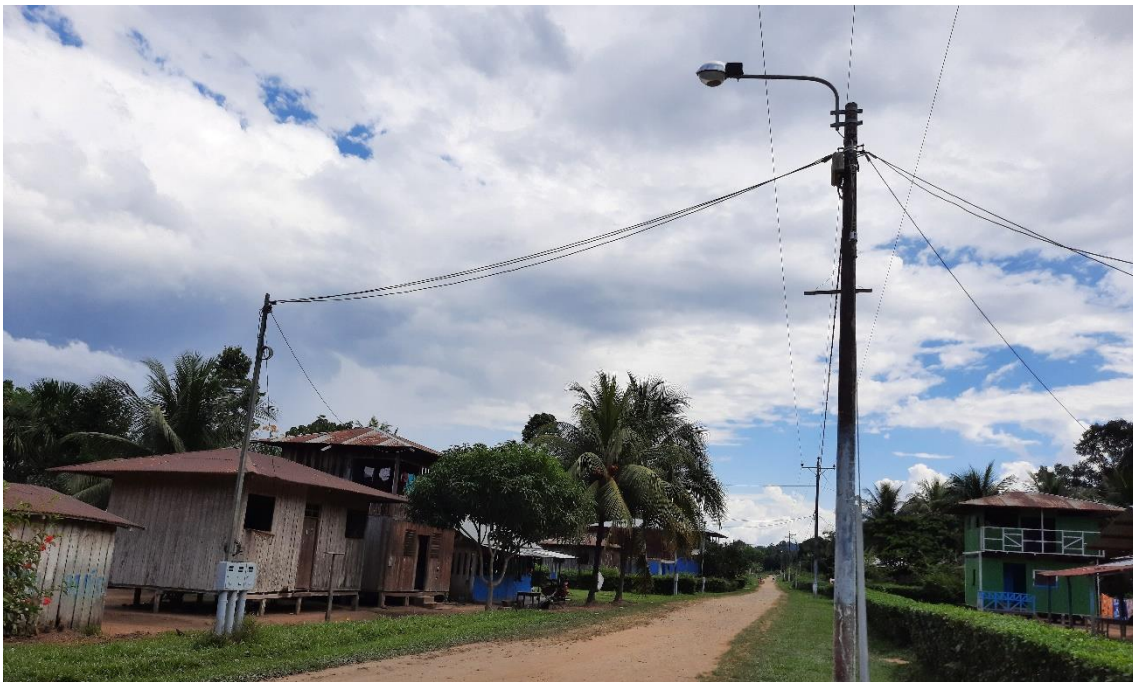
Fotografía N° 4. Red de energía eléctrica.
