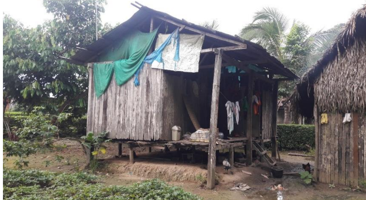
Imagen 19: Vivienda en mal estado de conservación
